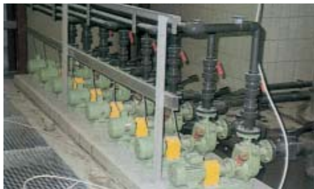
Series of stainless steel J40 pumps in a purification plant. Série de pompes J40 en acier inoxydable dans une installation d'épuration.
